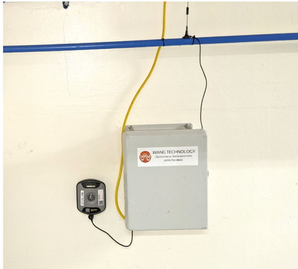
Monitoreo de vibraciones instalado en el sótano
